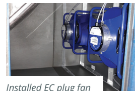
Installed EC plug fan
